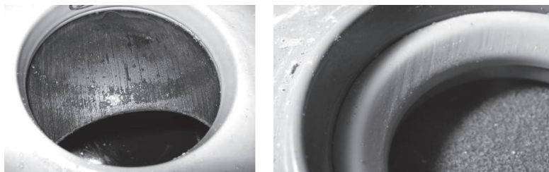
【図-8.23】 補修弁の弁体とシートの損傷例
