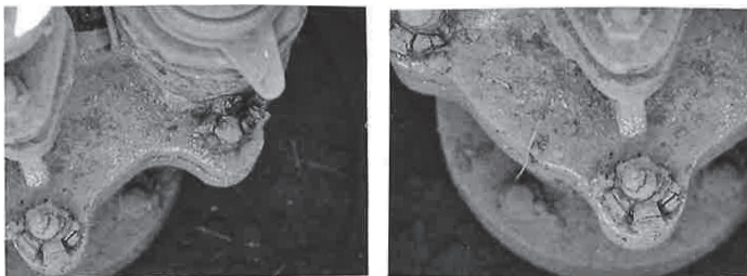
【図-8.20】 地下式消火栓のボルト・ナットの腐食例
