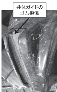
【図-8.12】 ソフトシール仕切弁の弁体ガイド損傷例
